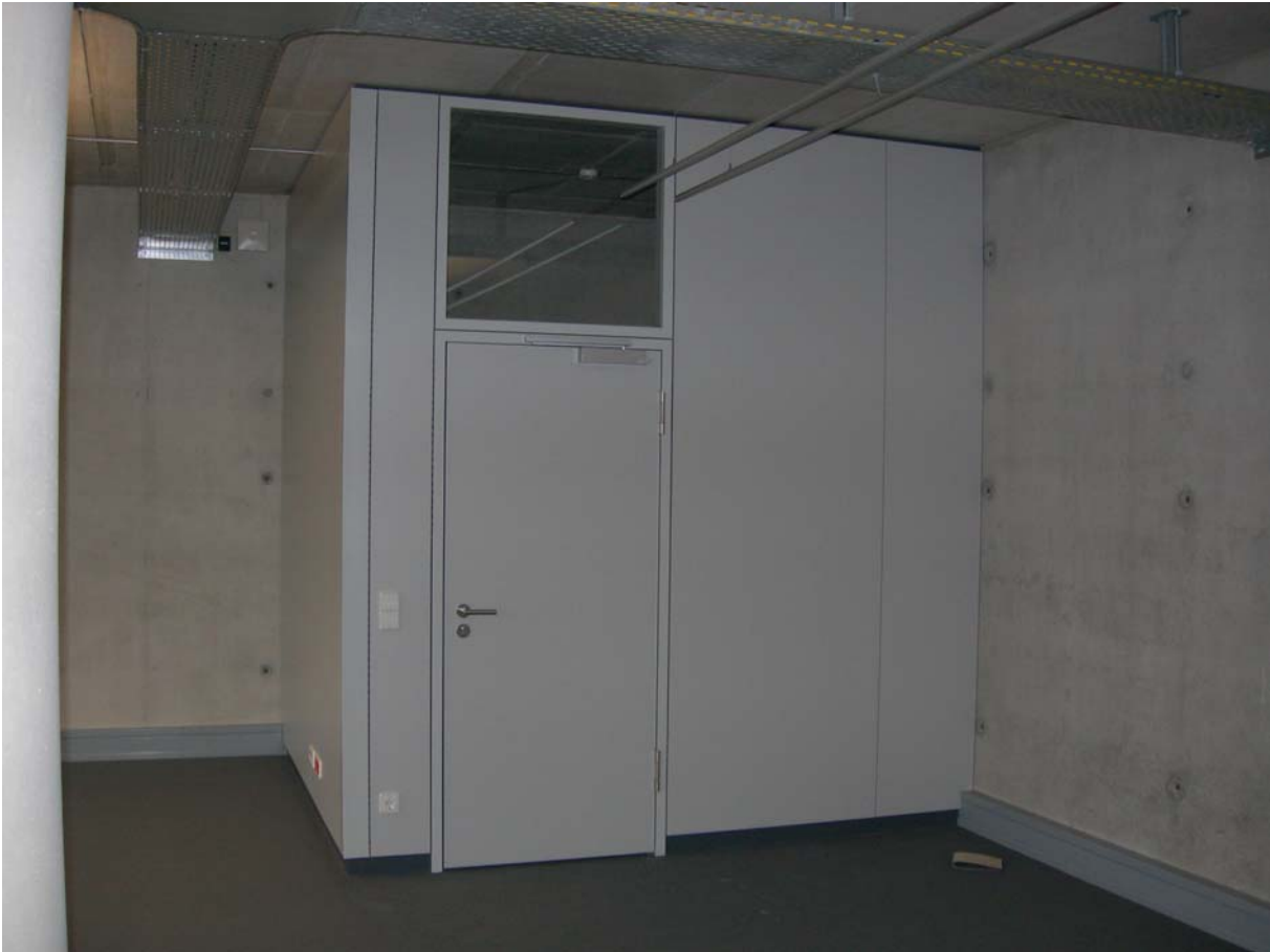
Abbildung 7: F90-Feuerschutz-Trennwände im Bürobereich
